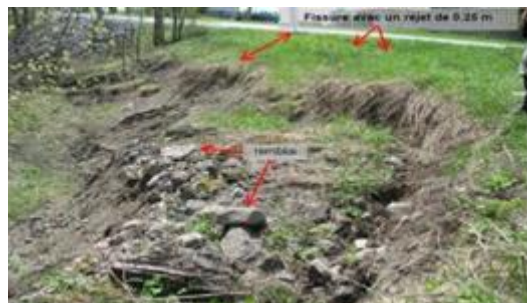
Fig. 2. Déformations du talus au 7 mai 2008.
