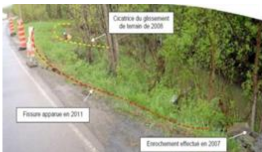
Fig. 7. Localisation de l'amorce du glissement de terrain (fissure) de 2011 par rapport au glissement de terrain de 2008 et de l'entrochement de 2007.
