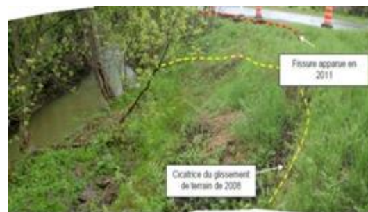
Fig. 6. Identification du glissement de terrain de 2008 et de la nouvelle amorce de glissement de terrain apparue en 2011.
