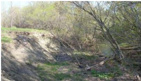
Fig. 1. Glissement rotationnel dans un talus de 4 m de hauteur et dont l'escarpement arrière occupe un angle de 52^\circ sur 1.5 m de hauteur.
