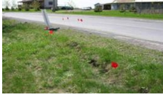
Fig. 3. À l'avant-plan, fissure avec un rejet de 0.25 m à 0.80 m de la route. Micro-fissure dans l'accotement de la route. Les petits drapeaux rouges marquent les fissures.
