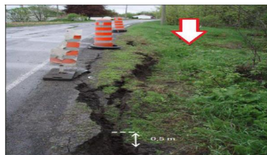
Fig. 8. Vue de la fissure avec rejet, apparue le 17 mai 2011.
