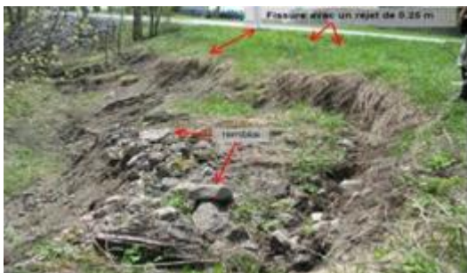
Fig. 2. Déformations du talus au 7 mai 2008.
