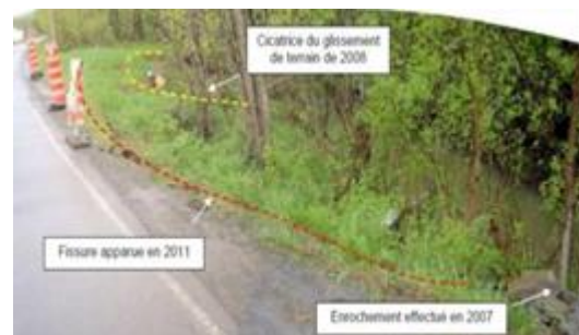
Fig. 7. Localisation de l'amorce du glissement de terrain (fissure) de 2011 par rapport au glissement de terrain de 2008 et de l'étrécissement de 2007.
